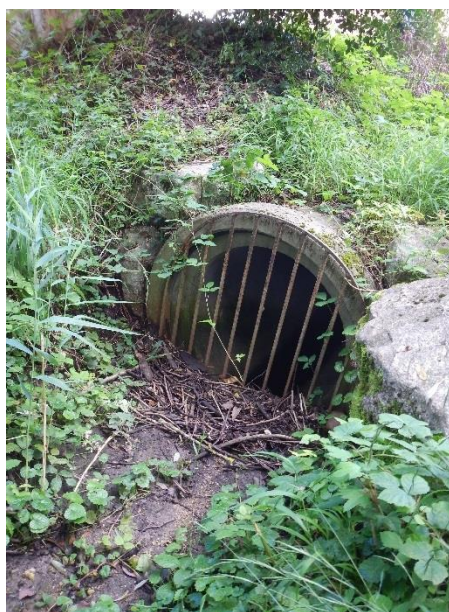
Photo 12: Buse évacuant les surplus pluviométriques
