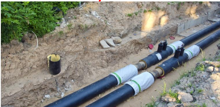
Réseau de chaleur
